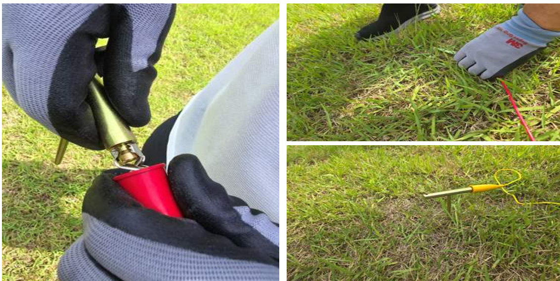
< 접지봉 및 리드선 연결(예시) >
